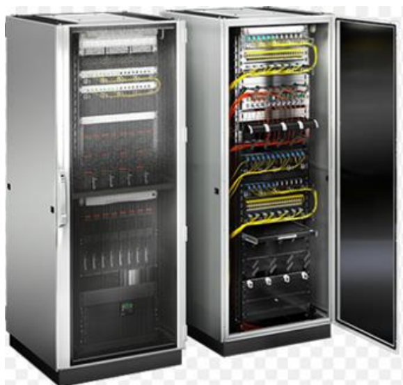
Рисунок 36 – Телекоммуникационный шкаф с установленным оборудованием
